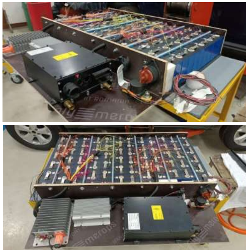
Fig. 6.12 Bateria de tracțiune și componente ale sistemului electric de propulsie montate pe o carcasa – șasiu
